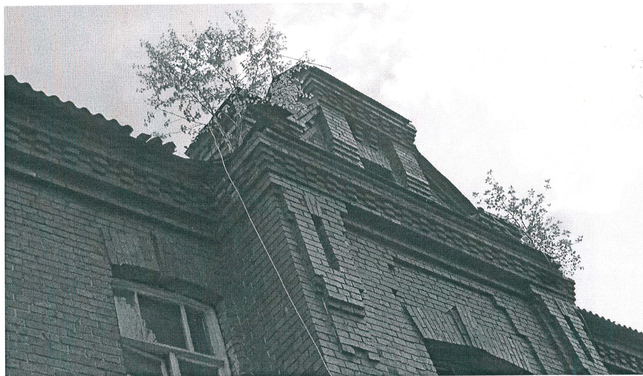
9. Фрагмент северо-западного ската кровли. Дефекты карниза, порось на крыше. Предмет охраны – кирпичный декор.
