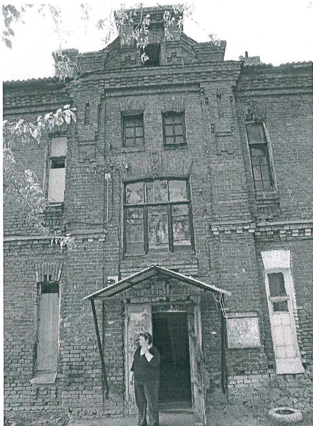
7. Ризалит главного фасада: поздние наслоения на входе. Дефекты декора. Утраты оконных заполнений.
