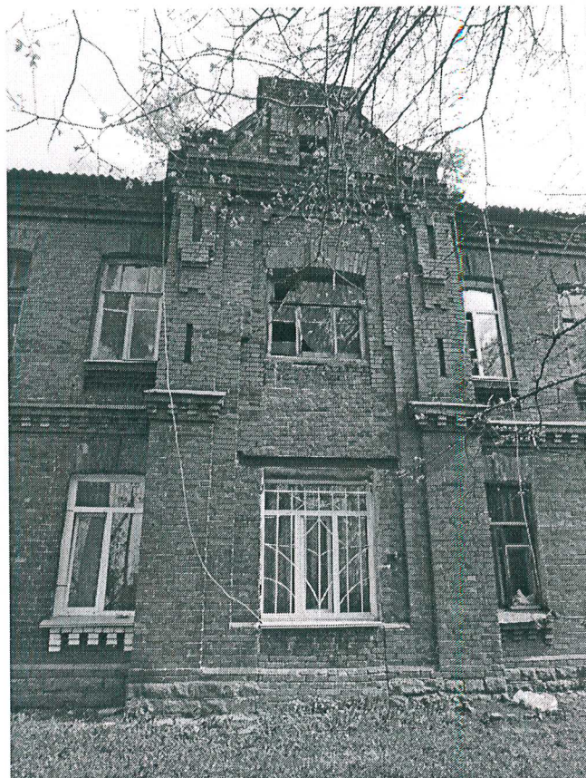
8. Ризалит дворового фасада: утрата первоначальных проемов, поздние наслоения.
