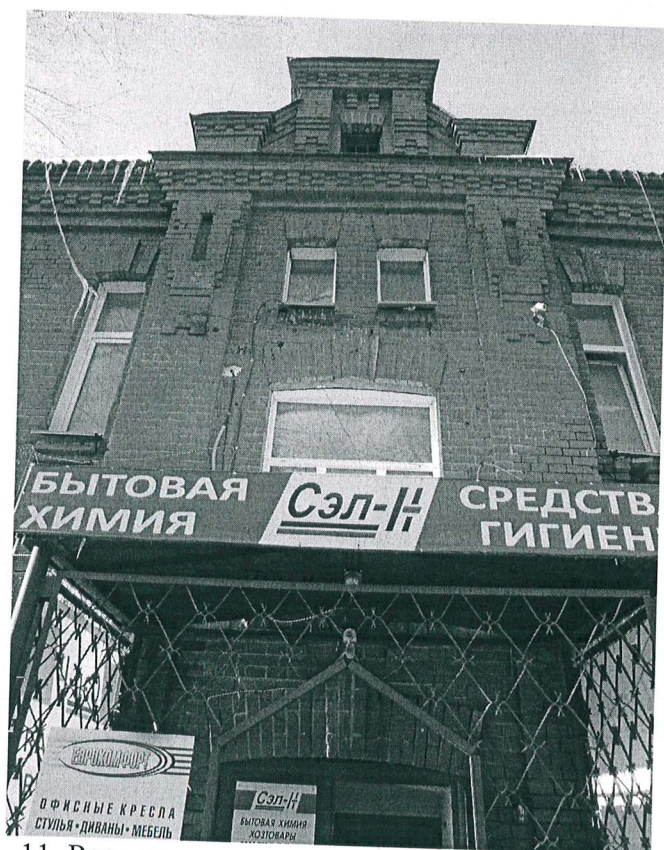
11. Ризалит главного фасада: искажение входа, рисунок оконных переплетов.
