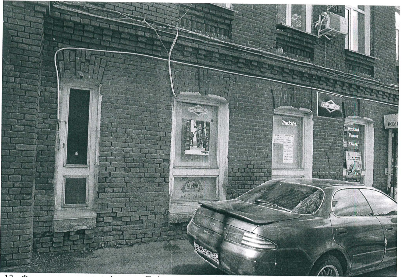
13. Фрагмент главного фасада. Дефекты кладки. Поздние наслоения – наружный блок кондиционера, элементы рекламы. Утрата рисунка оконных переплетов.
