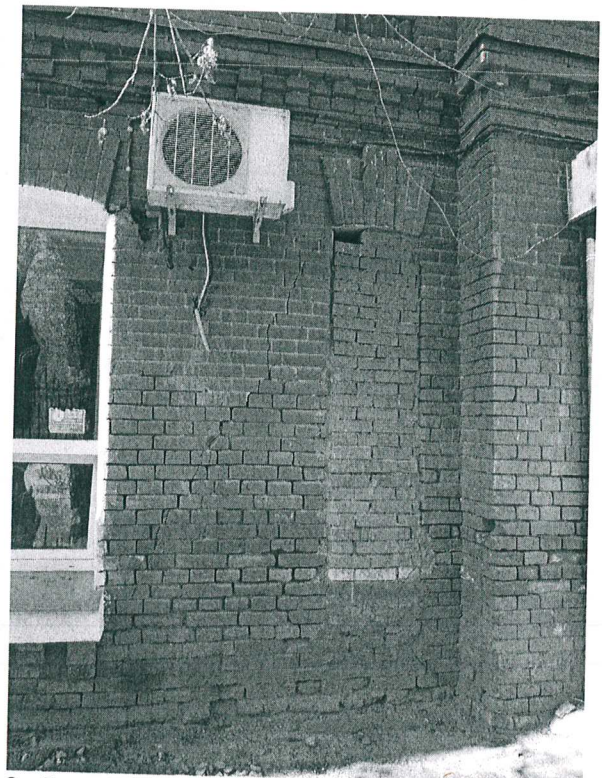
9. Фрагмент главного фасада. Трещина в кладке. Утрата оконного проема.
