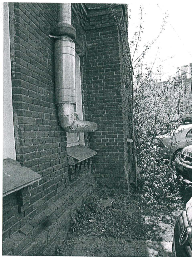
22. Фрагмент дворового фасада. Утрата покрытия отмостки и сорная поросль в зоне ризалита.
