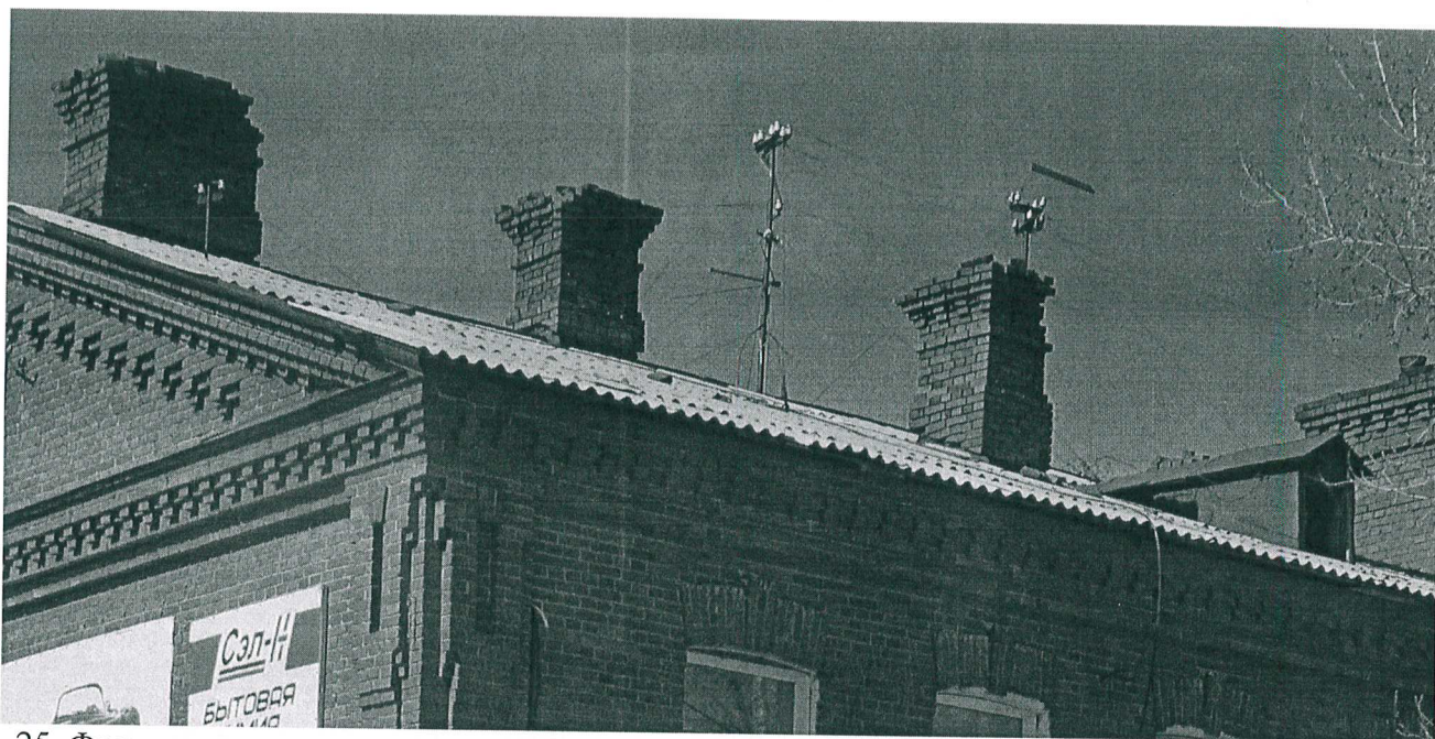
25. Фрагмент юго-восточного ската кровли. Дефекты элементов крыши.
