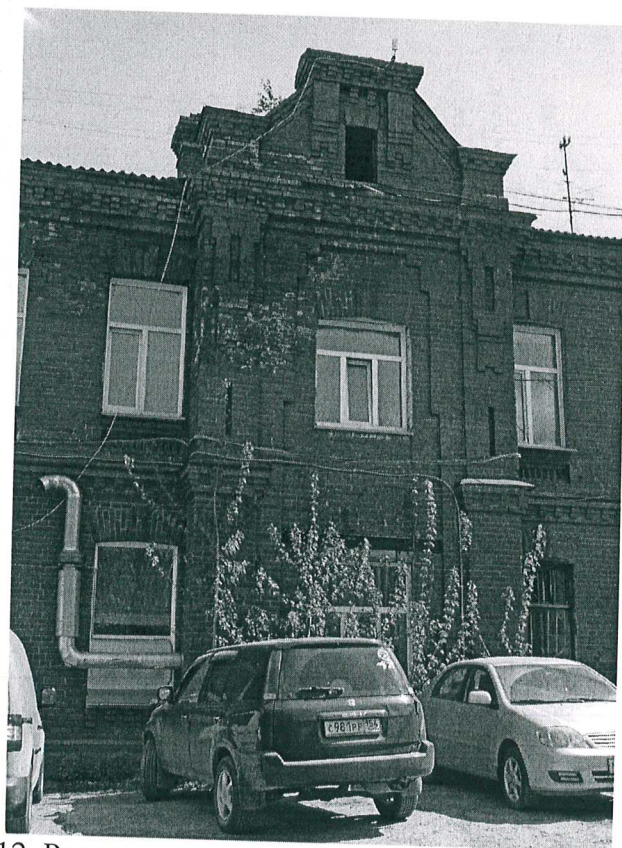
12. Ризалит дворового фасада: поздние наслоения, утрата первоначальных проемов.
