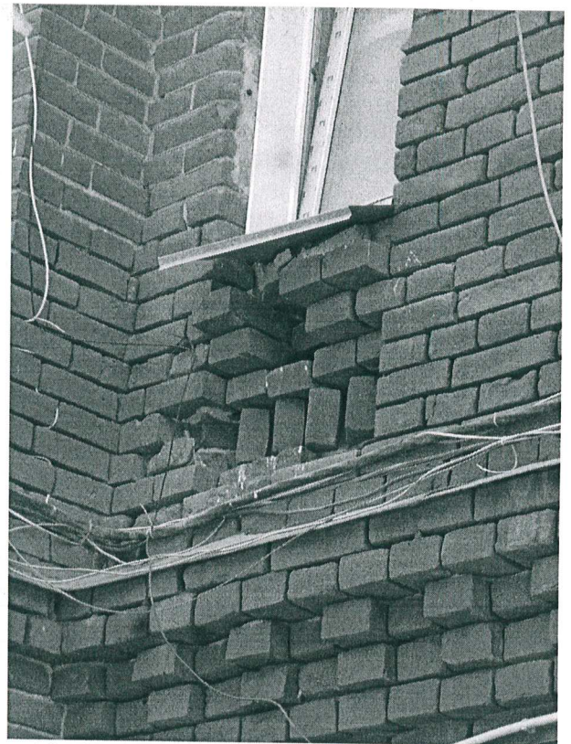
15. Фрагмент главного фасада. Дефекты кладки.
