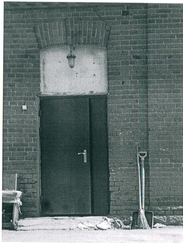
20. Фрагмент дворового фасада: утрата оконного проема (устройство дверного), трещина в кладке.
