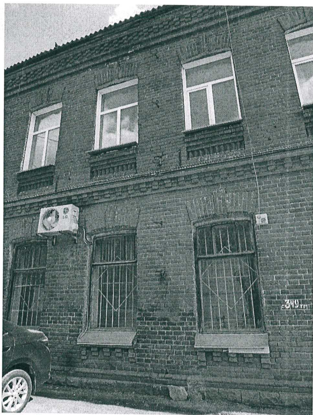
21. Фрагмент дворового фасада: дефекты стен и цоколя. Утрата элементов водостока, рисунка оконных переплетов.
