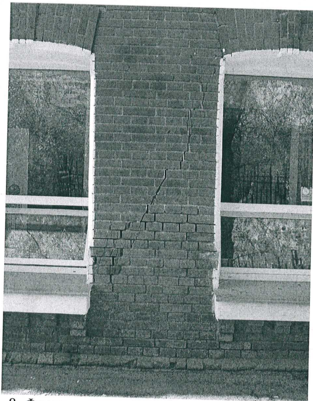
8. Фрагмент главного фасада. Трещина в кладке.
