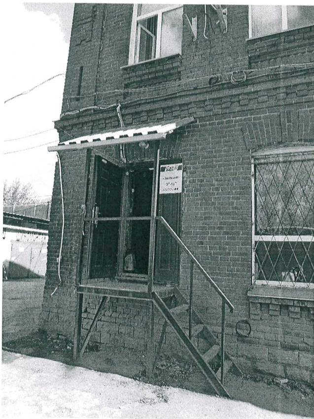
19. Фрагмент дворового фасада: утрата оконного проема. Поздние наслоения: крыльцо с навесом.
