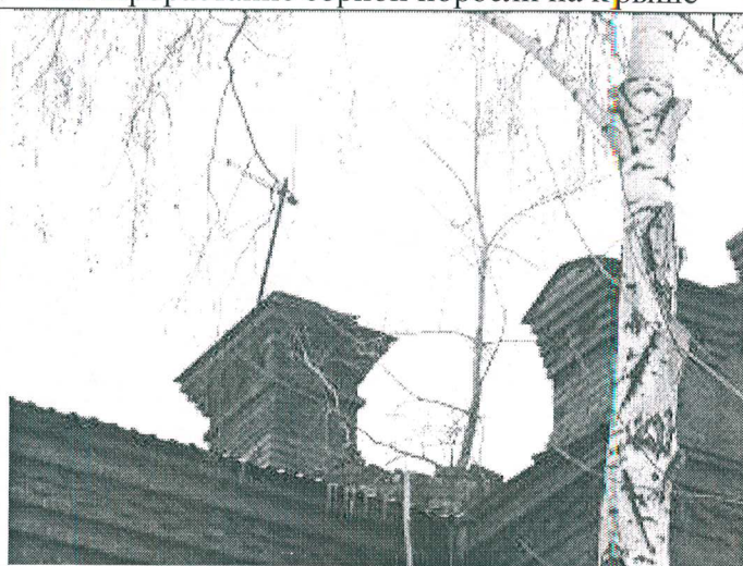
26. Прорастание сорной поросли на крыше
