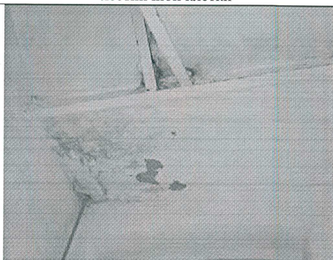
28. Следы протечек на потолке северной лестничной клетки
