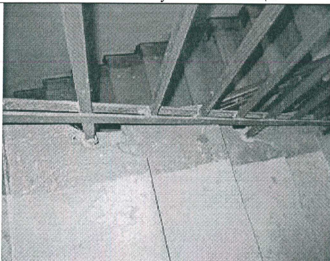
29. Сколы на ступенях лестницы
