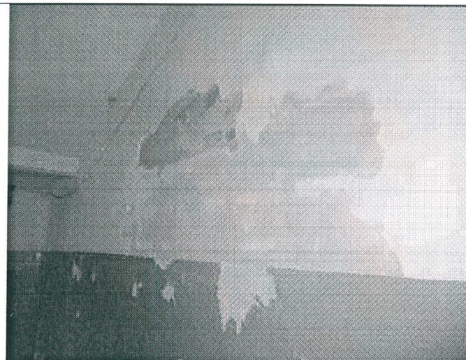
27. Дефекты отделки стен южной лестничной клетки
