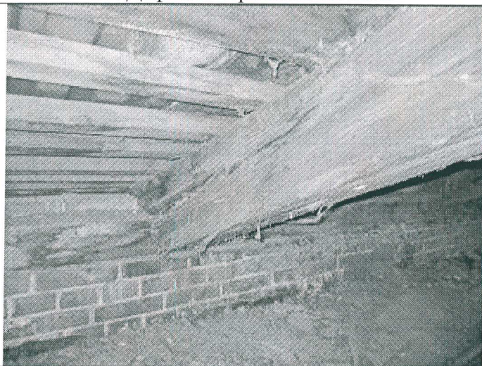
25. Дефекты стропильной ноги
