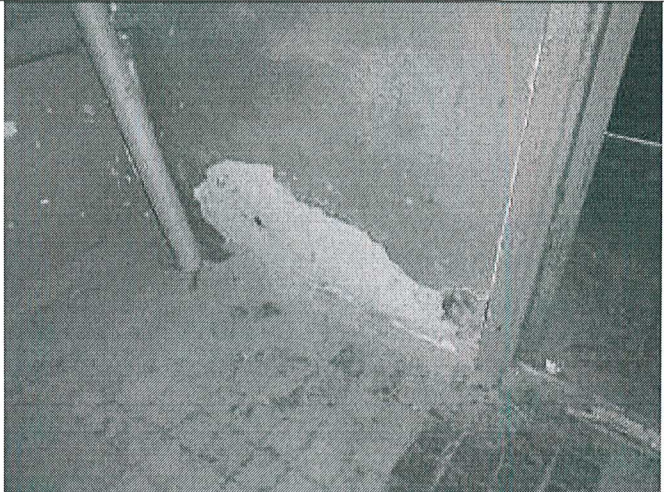
33. Дефекты отделки стен лестничной клетки
