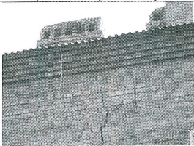
20. Трещина на северо-западном фасаде
