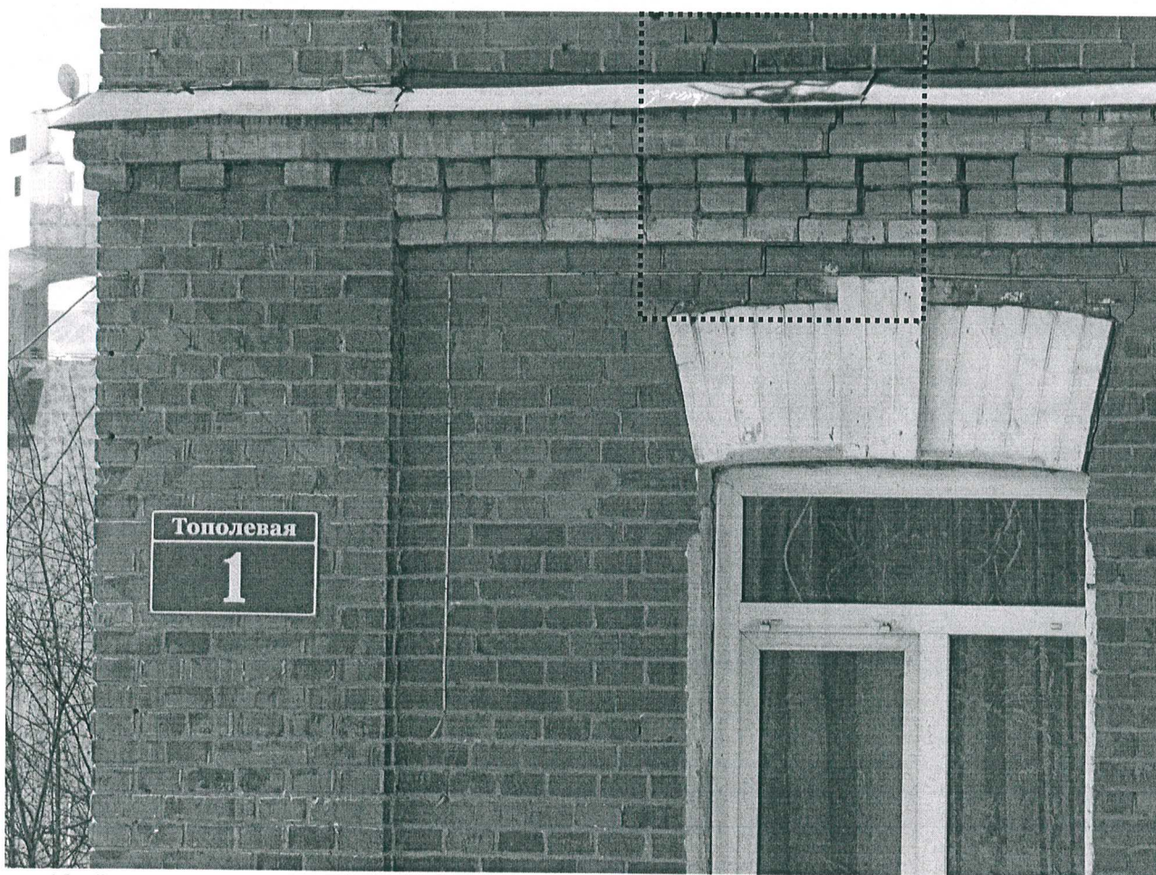
19. Фрагмент юго-восточного фасада в зоне южного угла (дефекты кладки в уровне междуэтажной тяги).
