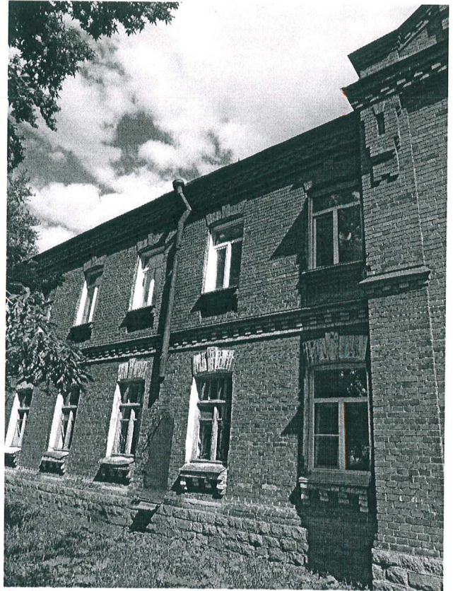
12. Фрагмент дворового фасада (центральная часть). Дефекты системы водостока.
