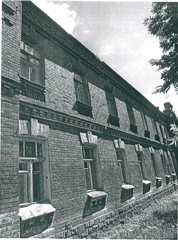
11. Фрагмент дворового фасада (центральная часть). Утрата системы водостока.
