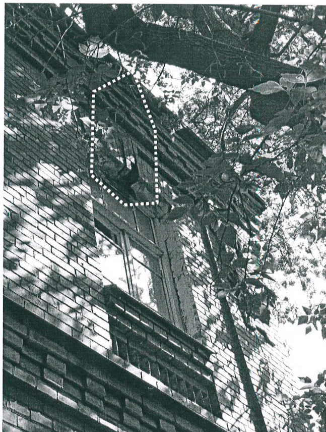
35. Фрагмент дворового фасада. Дефекты кирпичного декора. Предмет охраны: деревянное окно.
