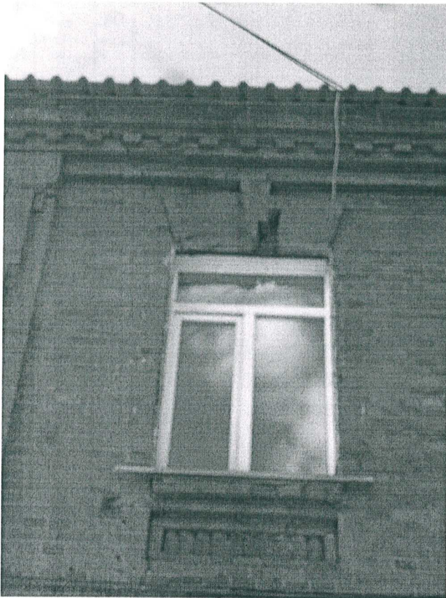
34. Фрагмент главного фасада. Дефекты кирпичного декора. Утрата предмета охраны: деревянного окна.
