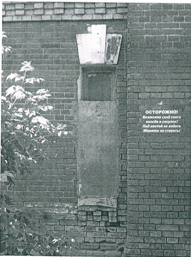
7. Фрагмент главного фасада. Утрата оконного проема 1-го этажа.
