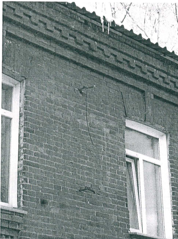
32. Главный фасад. Сохранившиеся крепления водосточной трубы.
