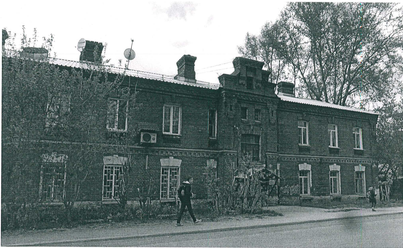
3. Фрагмент главного (юго-восточного) фасада. Поздние наслоения: наружный блок кондиционера с навесом; окна из профиля ПВХ; спутниковые антенны.
