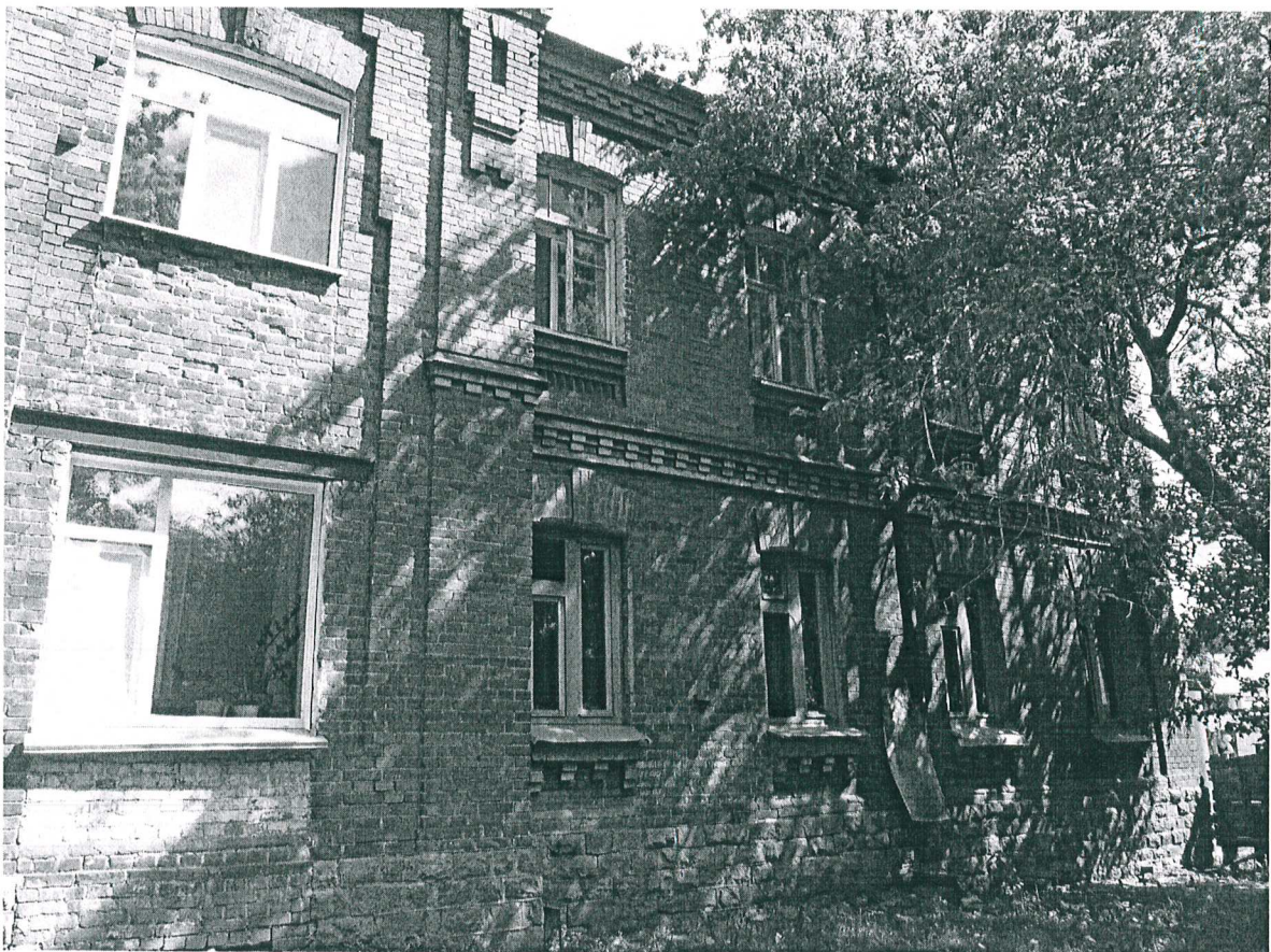
10. Фрагмент дворового фасада (южное крыло). Поздние наслоения: окна из профиля ПВХ и дерева (1 этаж). Предмет охраны – кирпичный декор, деревянные окна (2 этаж).
