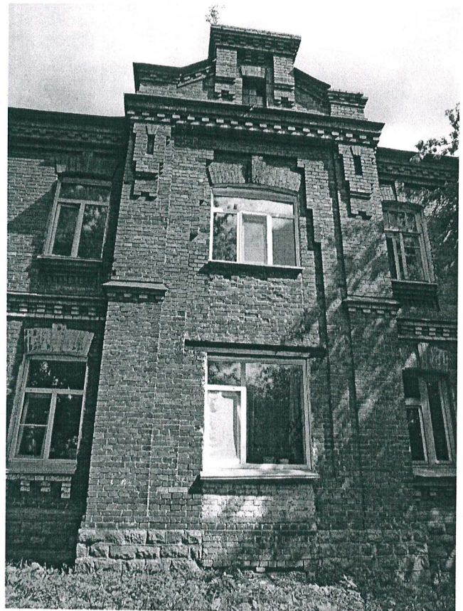
14. Ризалит дворового фасада (южный). Утрата первоначальных проемов, поздние наслоения. Поросль на аттике.
