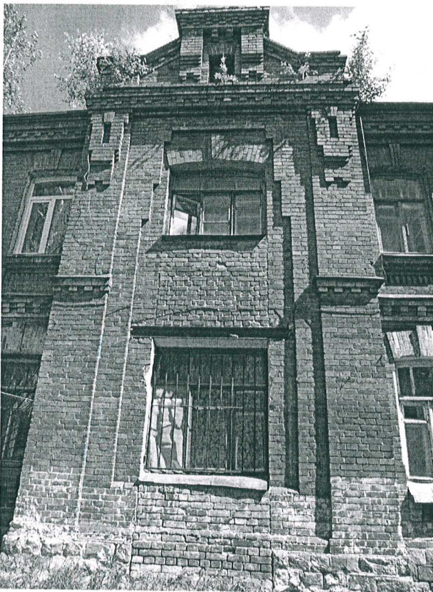
13. Ризалит дворового фасада (северный). Утрата первоначальных проемов, поздние наслоения. Поросль на карнизе.
