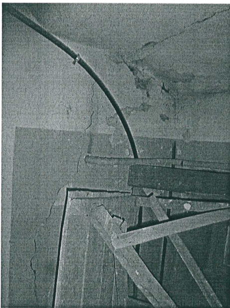
28. Трещина по внутренней стене лестничной клетки.
