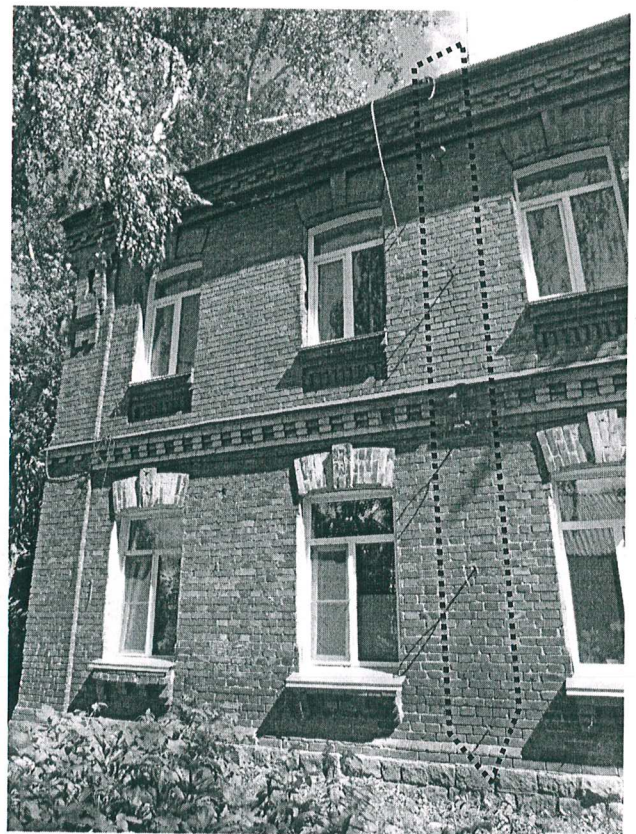
33. Дворовый фасад. Сохранившиеся крепления водосточной трубы.
