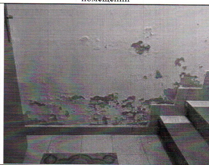
36. Дефекты отделки стен подвальных помещений
