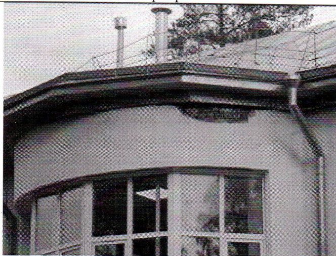
37. Дефект отделки стены в районе южного эркера
