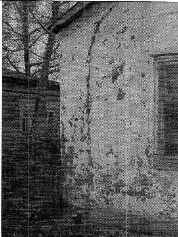
8. Трещина на восточном углу северо-восточного фасада. Фото май 2018 года.
