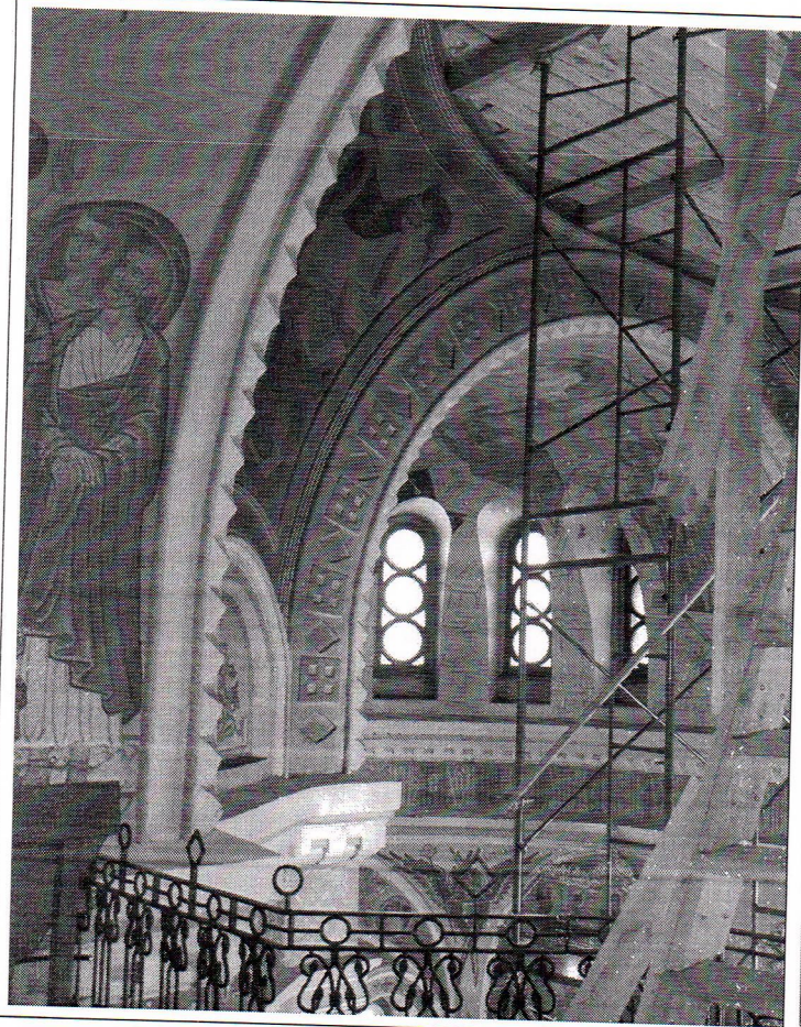
33. Фрагмент интерьера (потолки и стены с налетом копоти)
