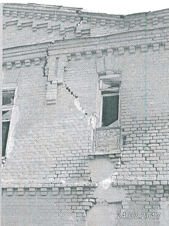
14. Состояние кирпичной кладки юго-западного фасада.
