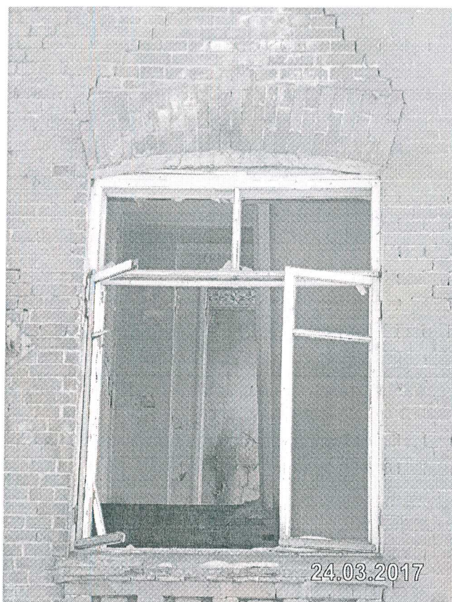
13. Трещины в кирпичной кладке правого ризалита северо-западного фасада.
