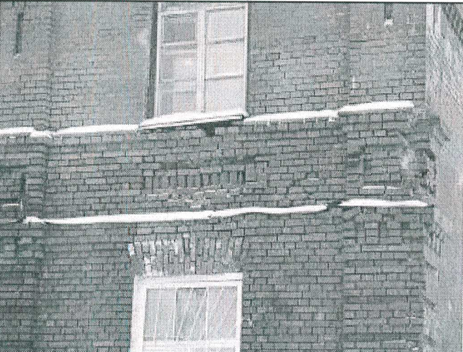
18. Деформации кирпичной кладки
