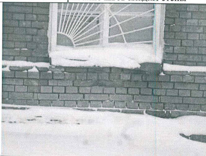
25. Выветривание швов кладки стены
