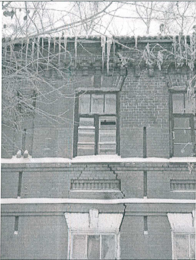
20. Трещины в кирпичной кладке
