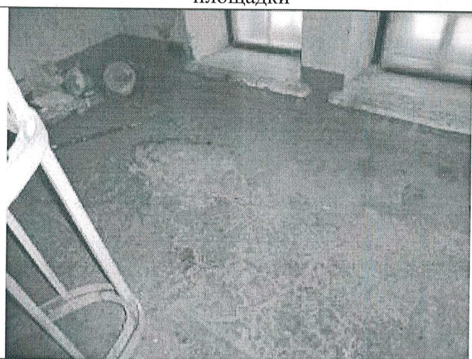
29. Дефекты бетонного покрытия лестничной площадки
