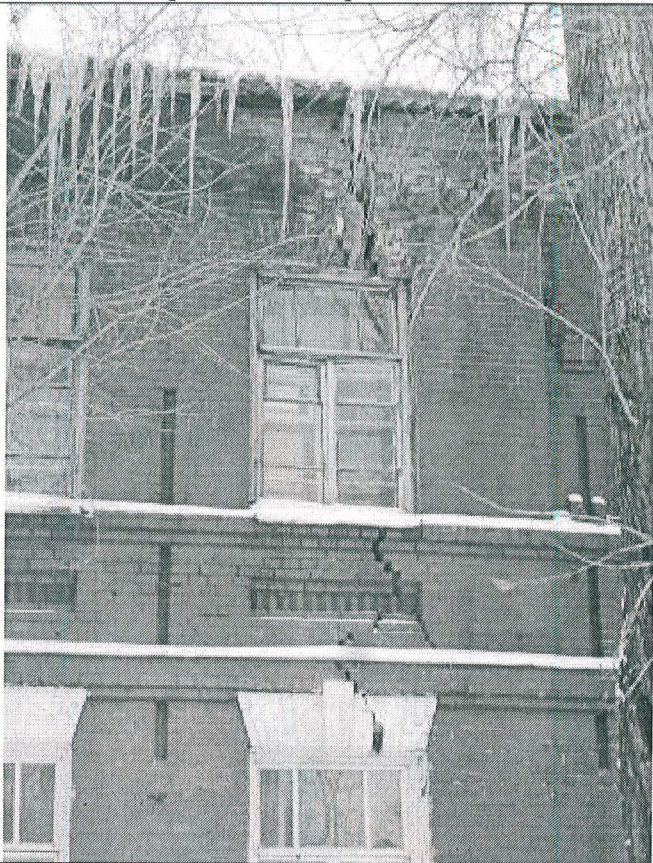
21. Трещины в кирпичной кладке
