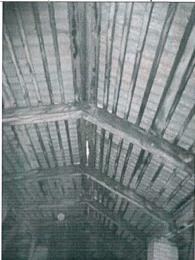
23. Щель в коньковой части крыши
