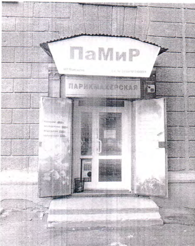
14. Центральный вход восточного фасада. Искажение облика левого портала.
