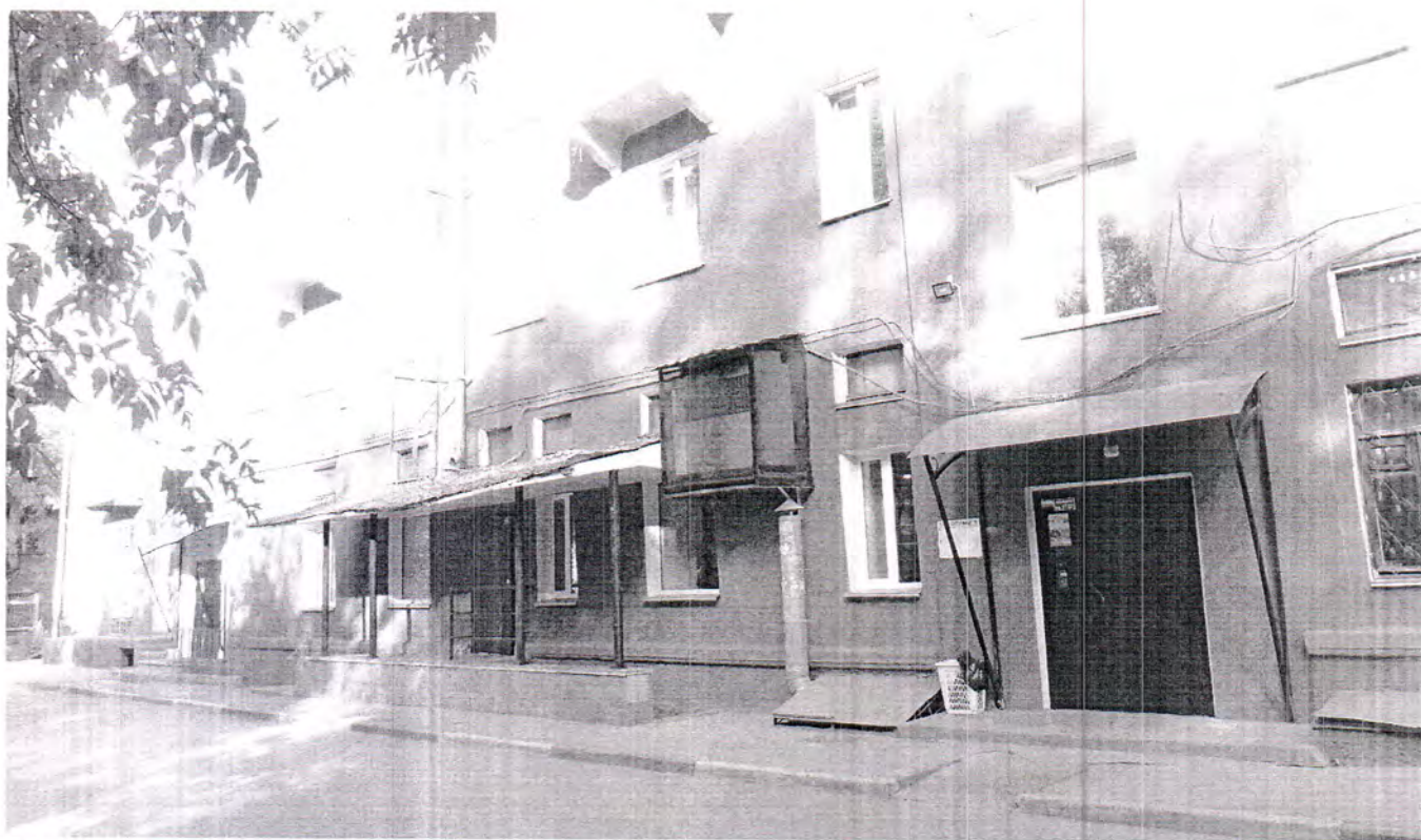
20. Фрагмент западного (дворового) фасада. Утрата портала входа в подъезд №2. Реконструкция крыльца с устройством приямка спуска.
