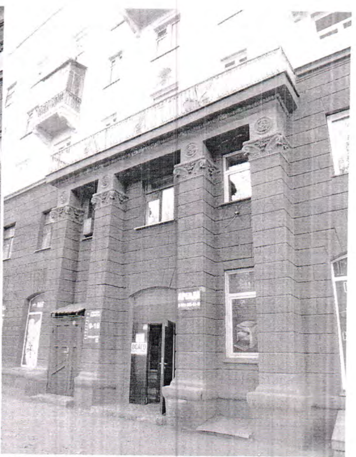
13. Портик правой стороны восточного фасада: Утрата первоначальных проемов.
