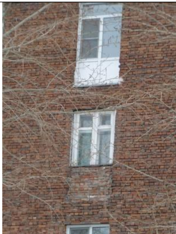
4.24. Фрагмент центральной части дворового фасада. Проемы утраченных «французских балконов» 5 и 6 этажей.
