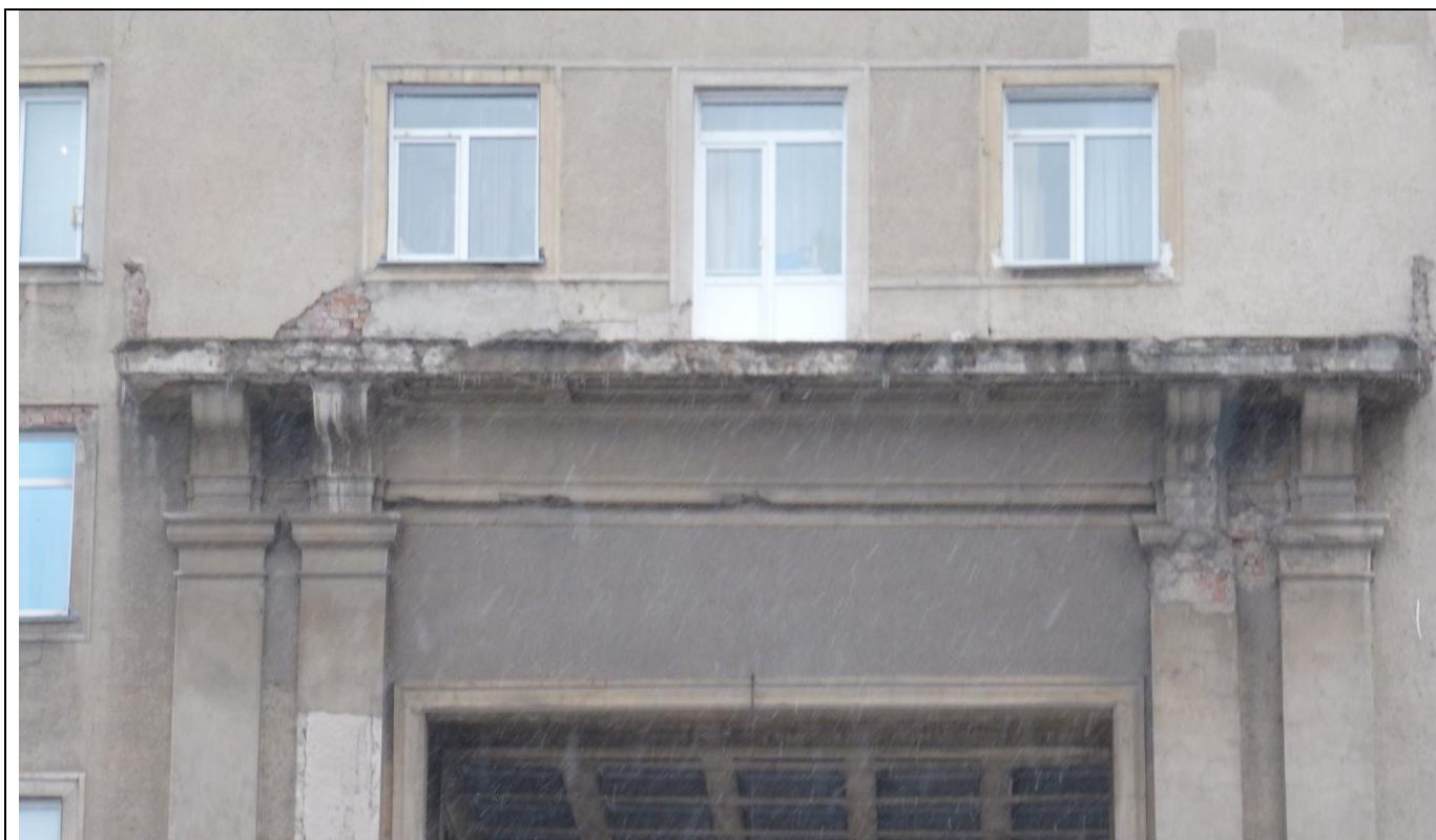
4.7 Фрагмент центральной части западного фасада. Разрушение балкона 6-го этажа
