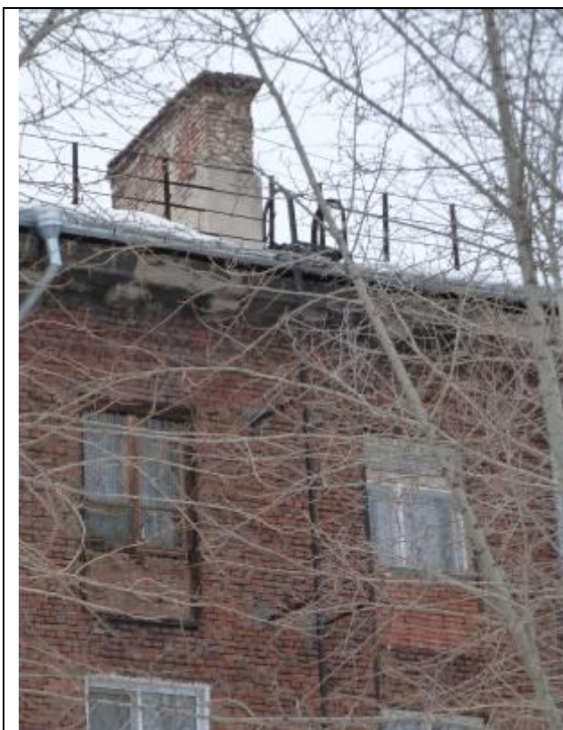
4.16. Северное крыло. Фрагмент дворового фасада в уровне 5-го этажа. Проемы утраченных «французских балконов».
