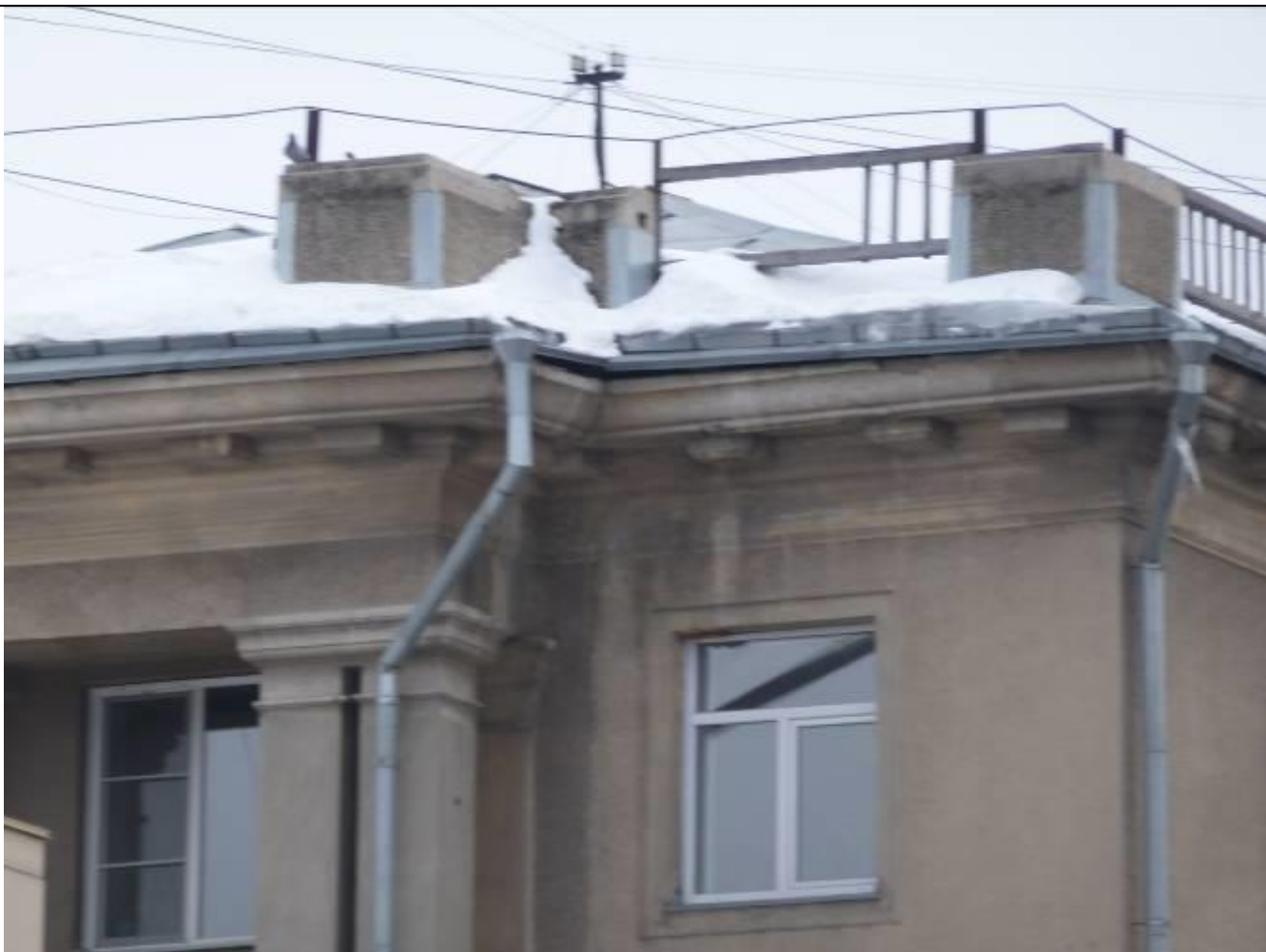
4.14. Фрагмент северного фасада. Разрушение ограждения кровли.
