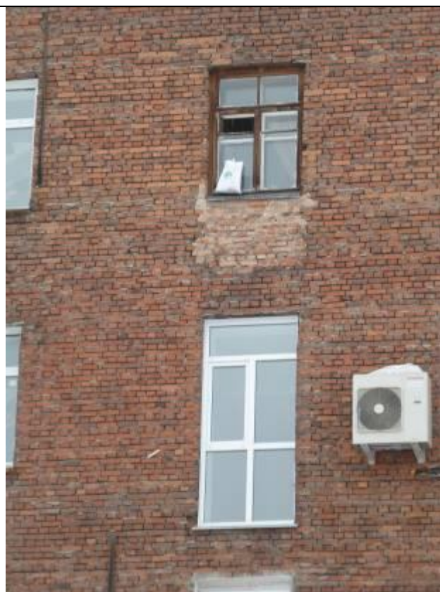
4.26. Фрагмент дворового фасада. Проемы утраченных «французских балконов» 5 и 6 этажей.
