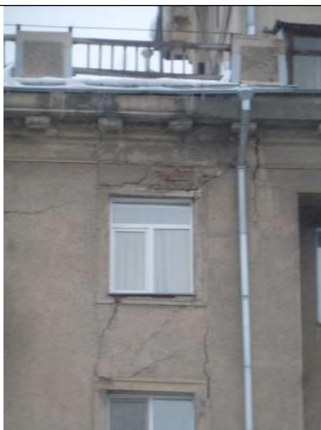
4.3. Фрагмент западного фасада северного крыла. Трещины в уровне 5 этажа.
