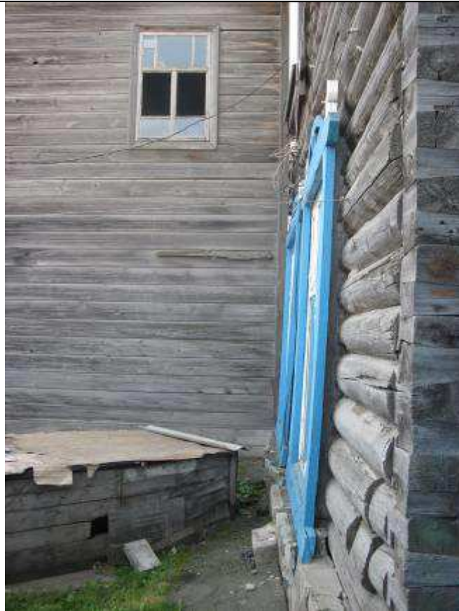
25. Окно пристройки. Дефекты стен и окон в западной части северо-восточного фасада.
