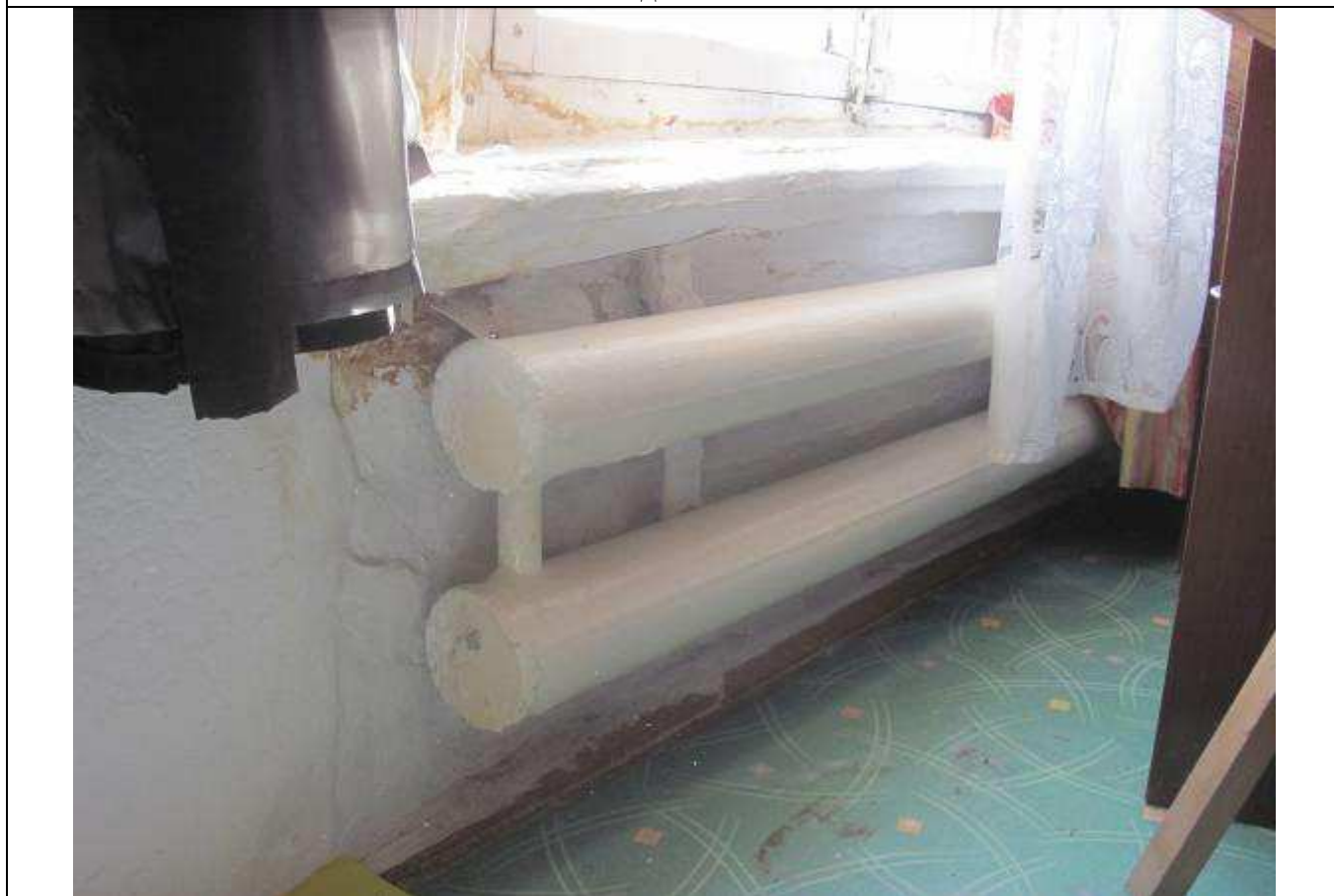
27. Состояние окон и подоконной части стен 1 этажа.
