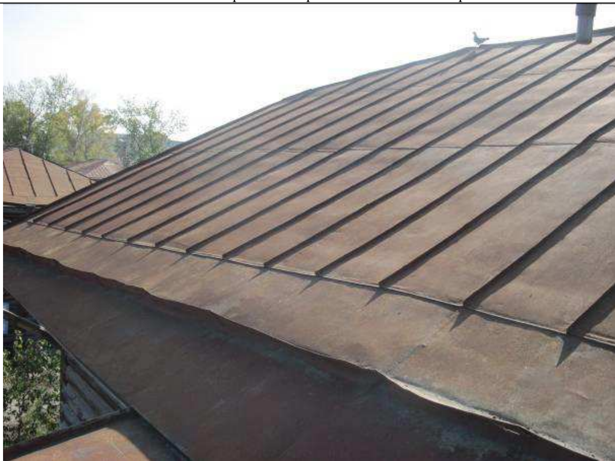
28. Состояние кровли северо-восточного свеса крыши
