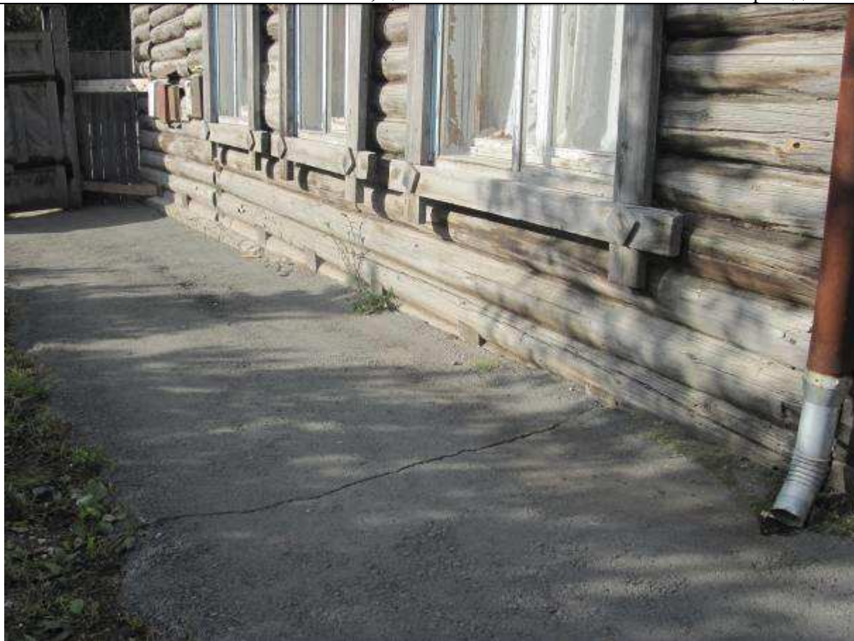
23. Состояние нижней части стен, цоколя и отмостки на юго-восточном фасаде
