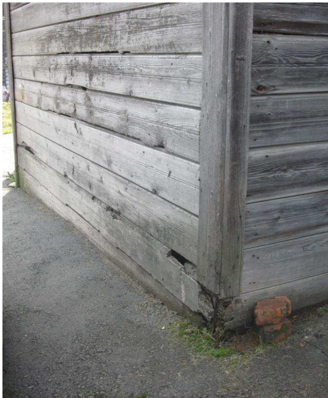
24. Дефекты нижней части стен двухэтажной пристройки
