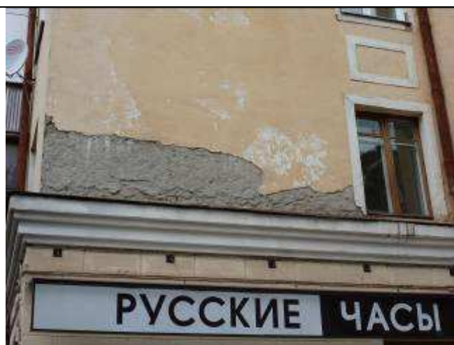
5.30. Дефект отделки южного фасада
