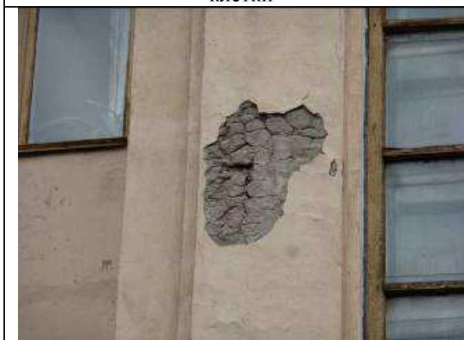
5.29. Дефект отделки ризалита лестничной клетки
