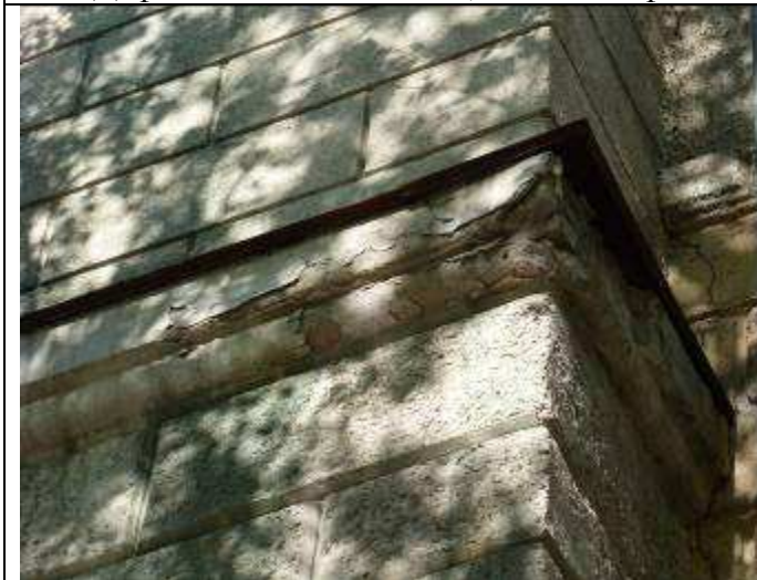
26. Дефекты отделки пояска, западный фасад
