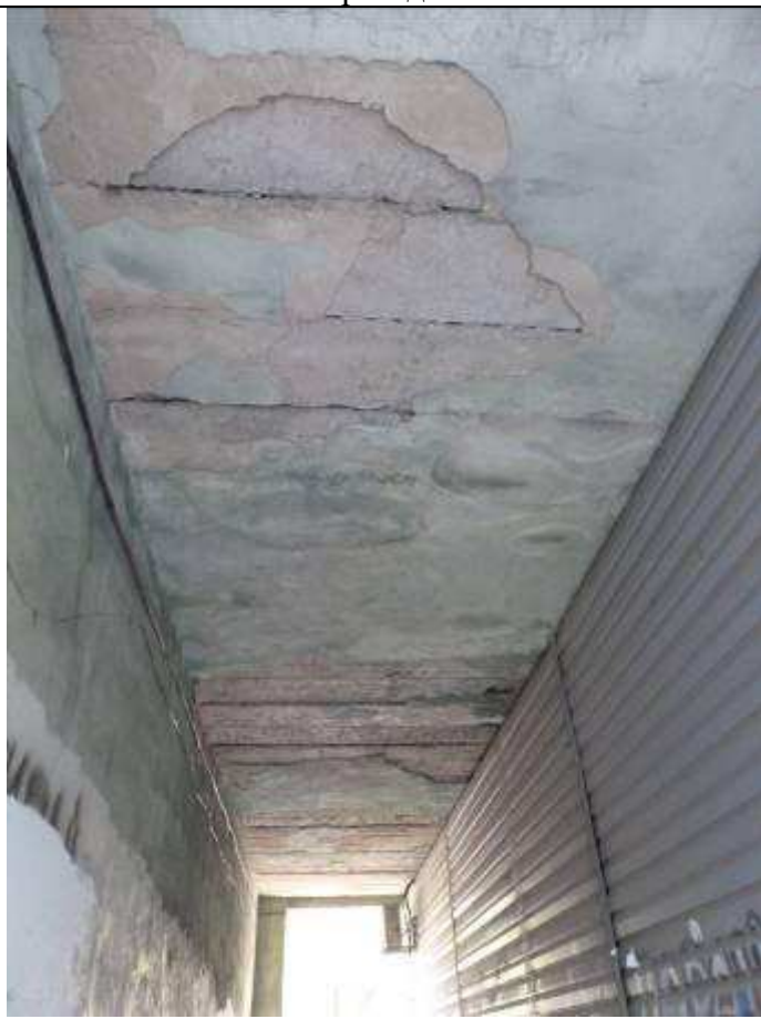
15. Дефекты потолочной поверхности арочного проезда
