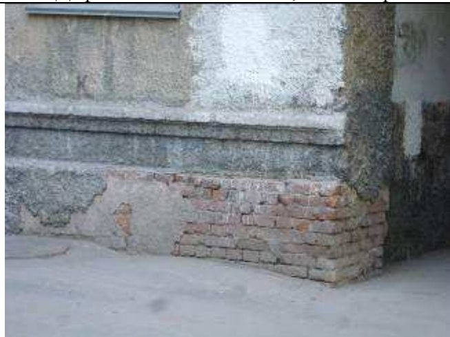
25. Дефекты отделки цоколя, южный фасад
