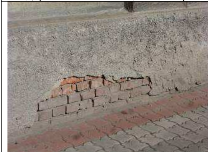
24. Дефекты отделки цоколя, западный фасад
