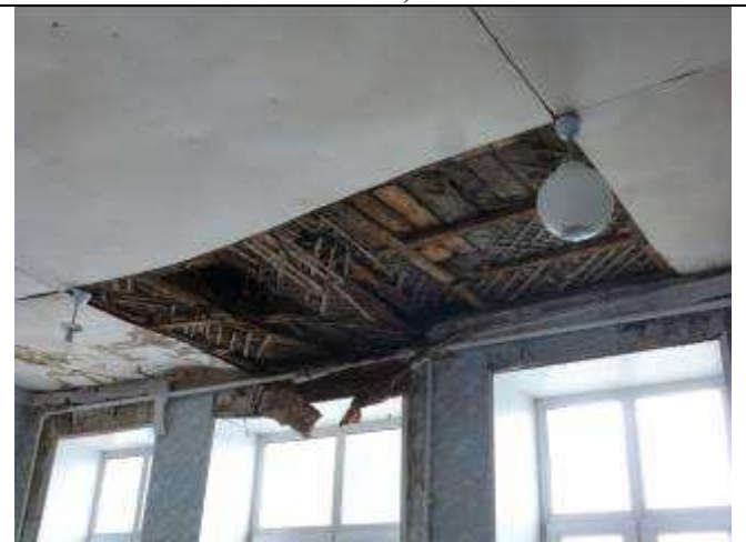
35. Отпадение элементов отделки потолка в местах протечки (восточный объем, третий этаж)
