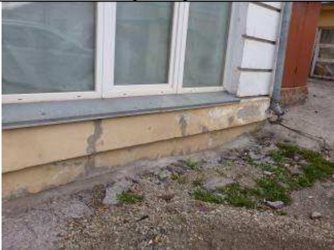
28. Дефекты отмостки и отделки цоколя на дворовом фасаде
