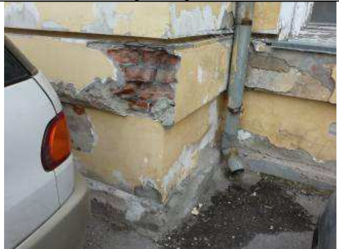
29. Дефекты отделки стены и цоколя на дворовом фасаде
