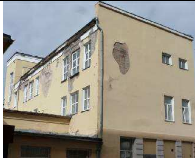
31. Дефекты отделки стен в восточном объеме
