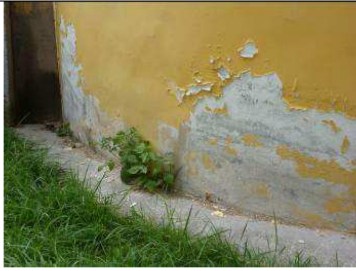
30. Дефекты отмостки и отделки цоколя в полукруглом объеме
