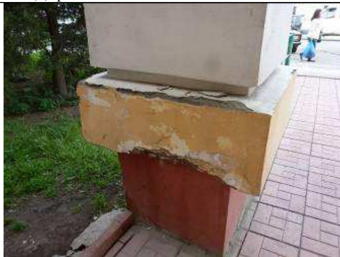
33. Дефекты отделки колонны главного входа
