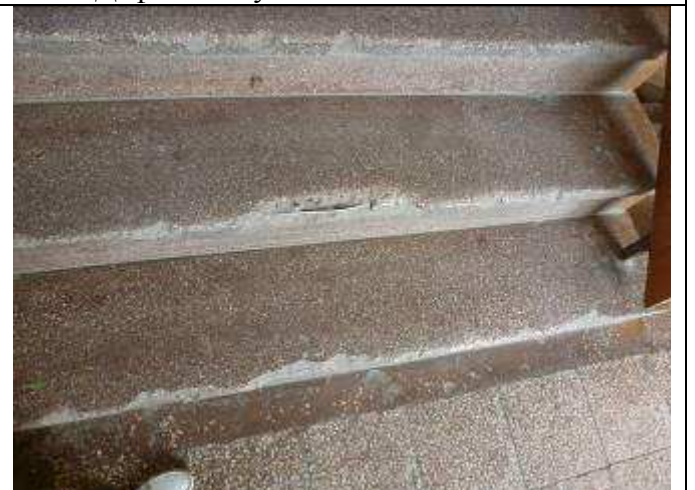
25. Дефекты ступеней на главной лестнице
