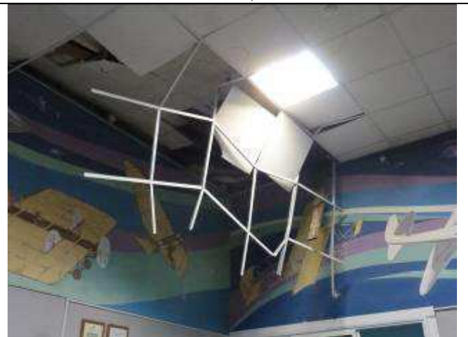
34. Отпадение элементов отделки потолка в местах протечки (помещение музея, первый этаж)
