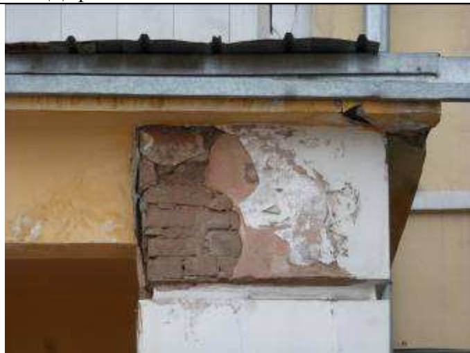
32. Дефекты отделки колонны главного входа
