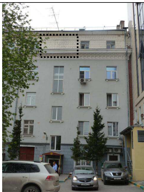
4.7. Фрагмент дворового фасада. Утрачен оконный проем.
