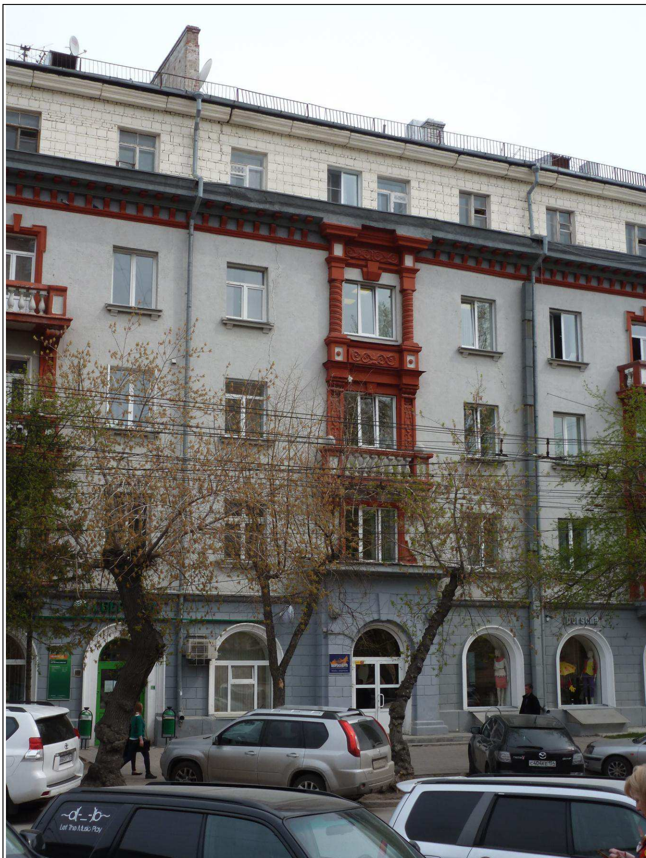
4.9. Фрагмент главного фасада по месту образования трещин.
