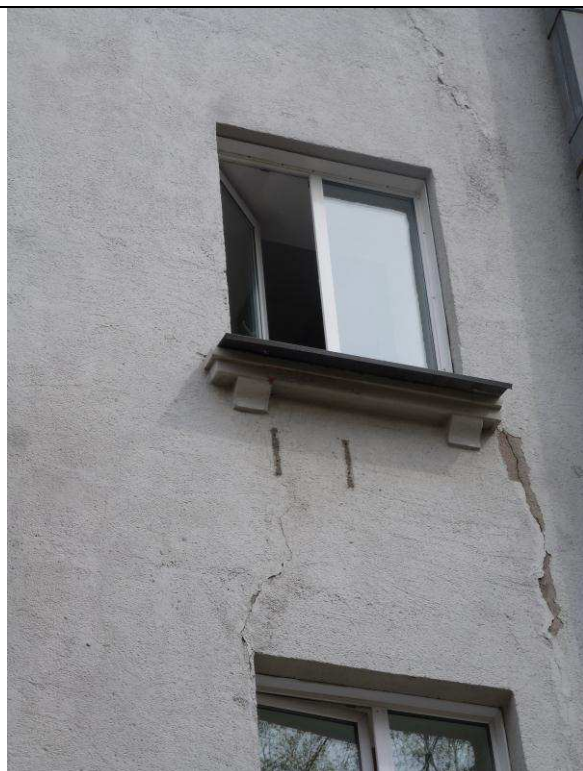
4.12. Трещина в уровне 2-3 этажей.
