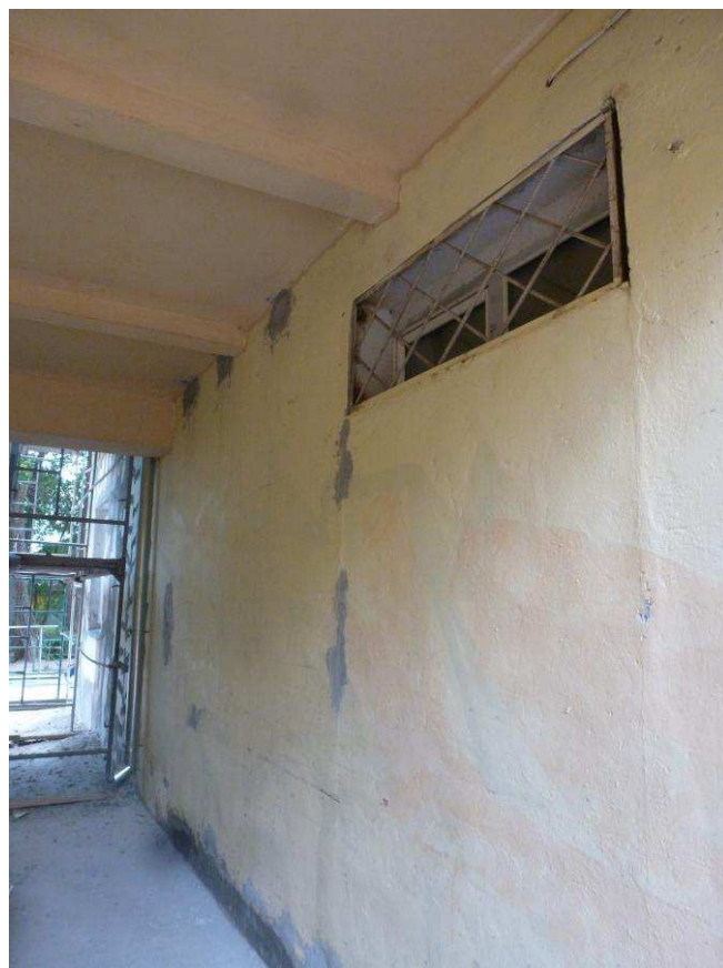
5.12. Фрагмент восточного дворового фасада. Утраченный дверной проем (в арке).
