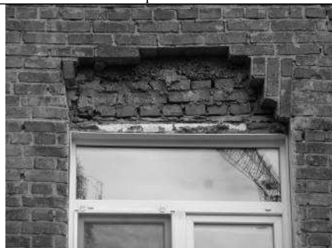
20. Выпадение кирпичей из оконной перемычки
