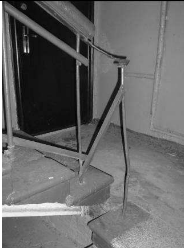
24. Дефекты лестничного ограждения, 1 этаж
