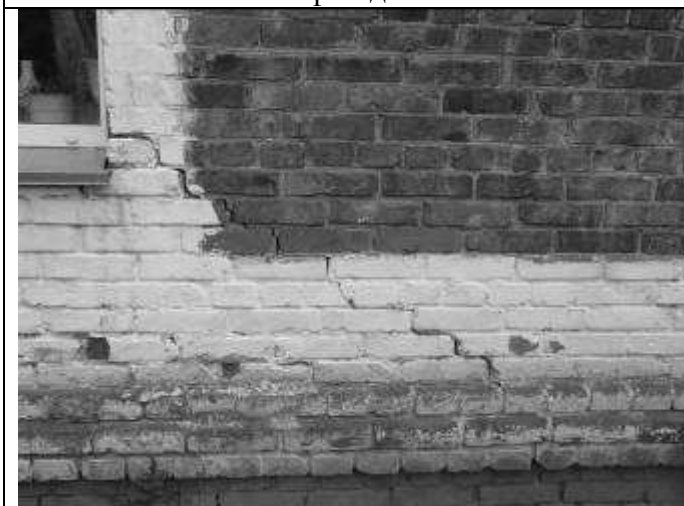
19. Трещина в кладке стены, северо-западный фасад
