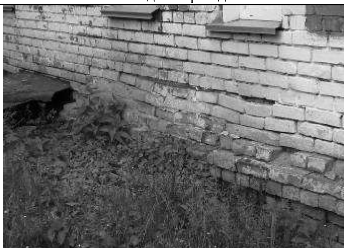
18. Деформация кирпичной кладки, северо-западный фасад
