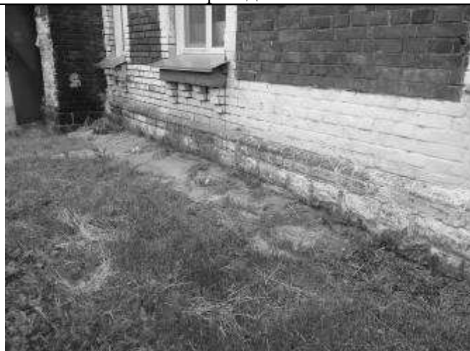
22. Дефекты отмостки на северо-западном фасаде
