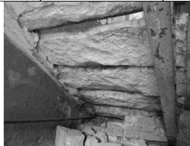
27. Дефекты нижнего лестничного марша
