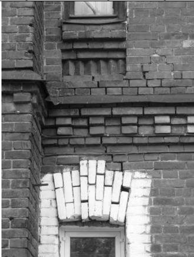
13. Трещины в стене северо-западного фасада
