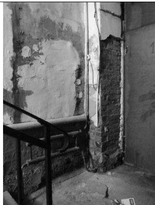
29. Дефекты отделки стен в лестничной клетке
