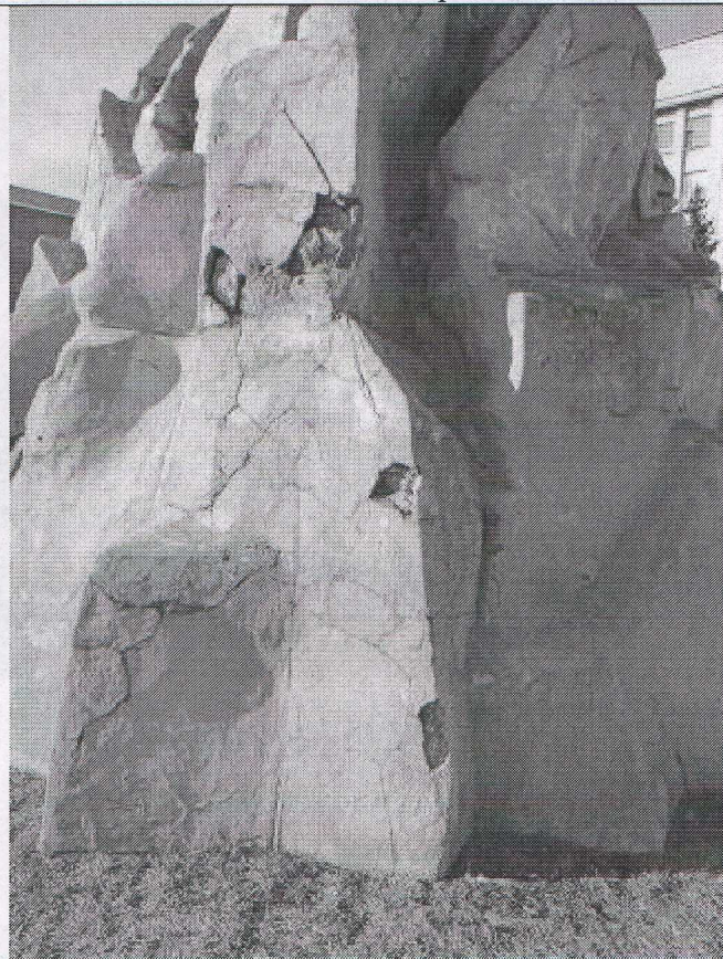
10. Дефекты покрытия монумента, юго-восточная сторона
