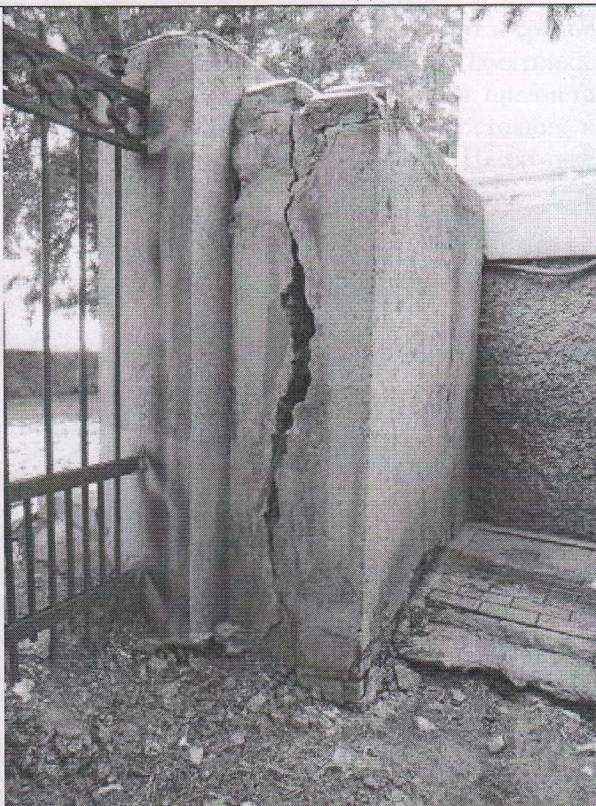
54. Дефекты опорного столба ограды на главном входе
