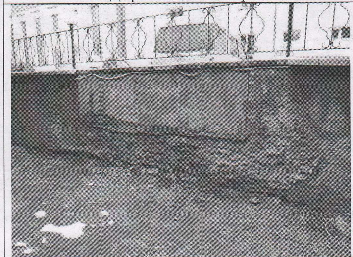
48. Дефекты цоколя ограды
