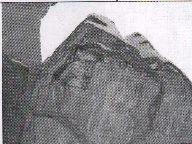
8. Дефекты покрытия монумента, северо-восточная сторона
