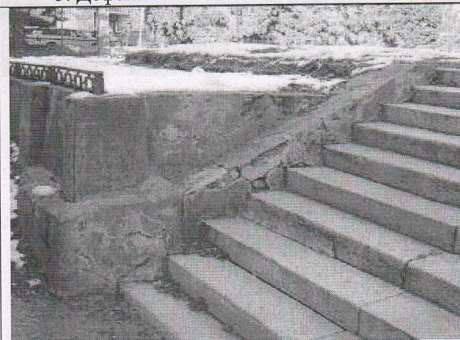
5. Дефекты боковой стенки лестницы
