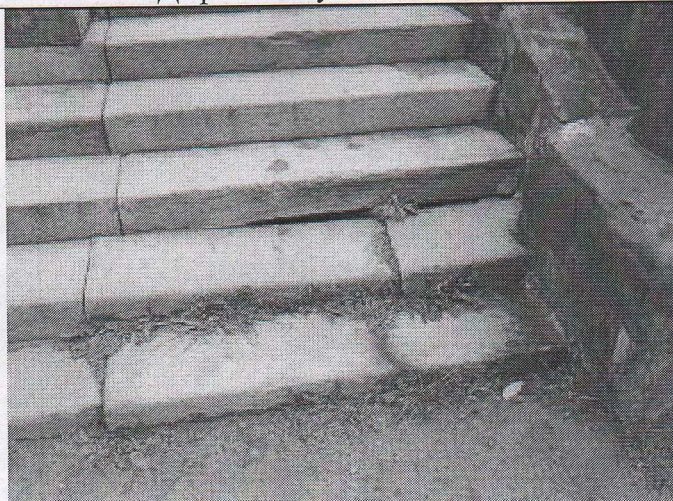
4. Дефекты ступеней лестницы
