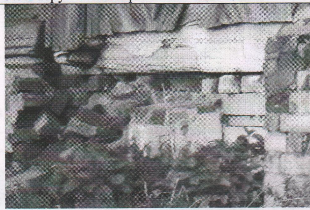
5.5. Разрушение кирпичных стен цоколя.
