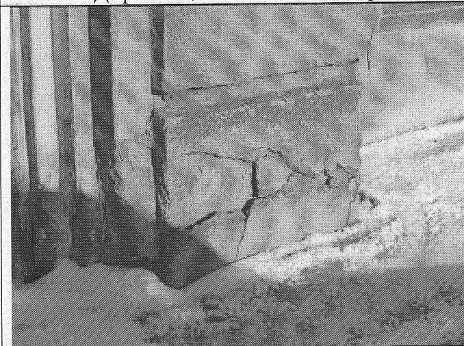
5.32. Дефекты цоколя на главном фасаде
