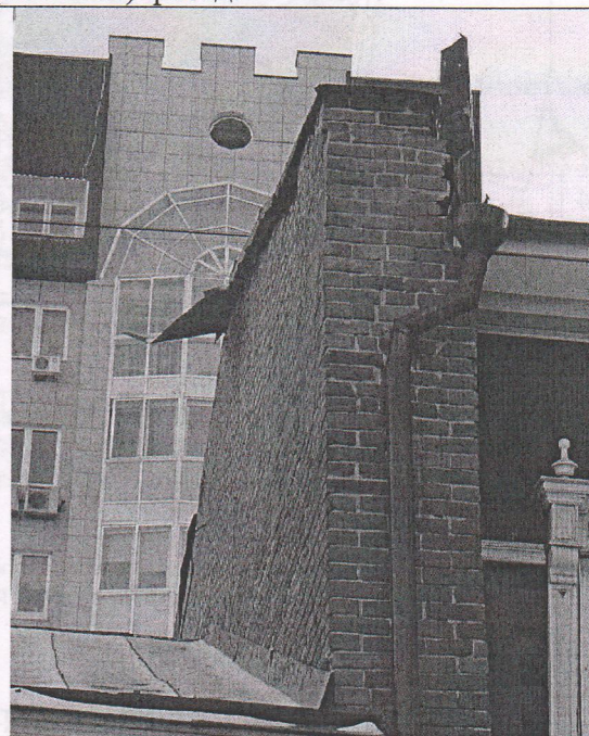
Фото № 3. Фрагмент брандмауэрной стены восточного фасада.
