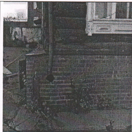
5.9. Дефект цоколя западного фасада
