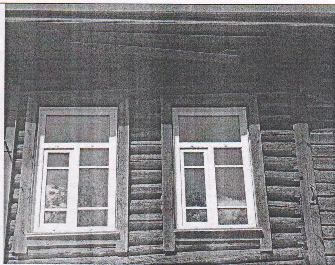
5.8. Провисание подкарнизных досок на юго-восточном (дворовом) фасаде.
