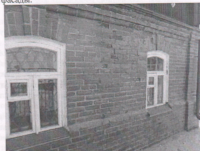
Фото 4. Фрагмент юго-западного фасада. Расслоение кирпичей в кладке стены.
